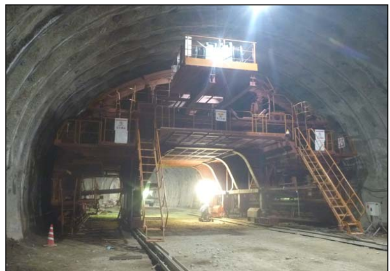
【本坑② セントル(移動式の型枠)】
